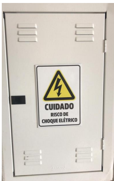
Figura 4 – Quadro de Distribuição Metálico com barramento e Sinalização.
